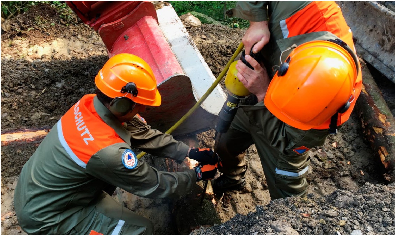
Instandstellungsarbeiten sollen neu als Ausbildung gelten und als Wiederholungskurse geleistet werden. Im Bild: Pioniere der Zivilschutzorganisation Nidwalden verschrauben Holzstämme mit Armierungseisen.
